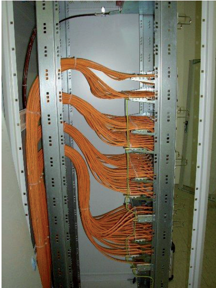
Blick in den Serverraum während der Bauphase.
